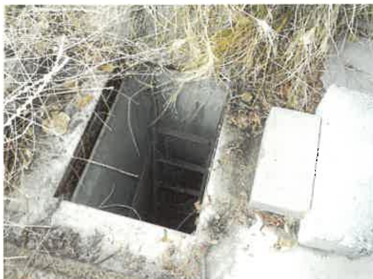
NO 7 地下物置入口
